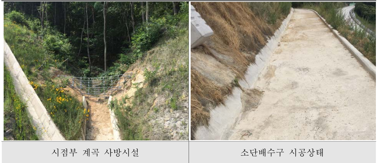
【표 8.2.3】 배수시설 손상물량
