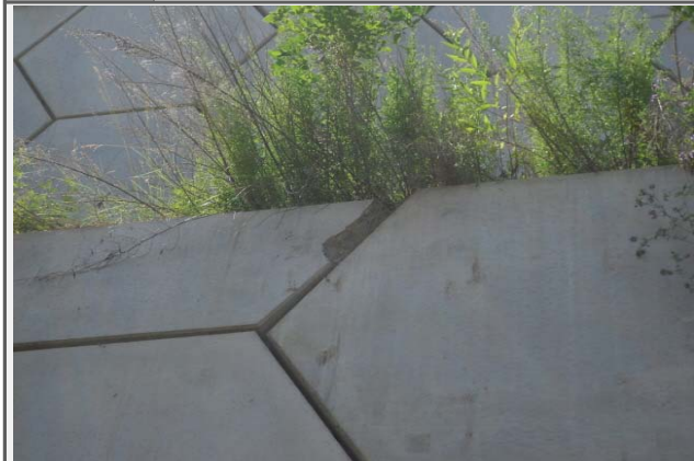
내 용 9+710 1단 벽체 파손
