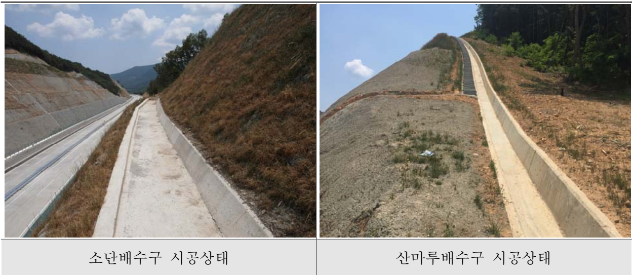
【표 5.2.4】 배수시설 손상물량
