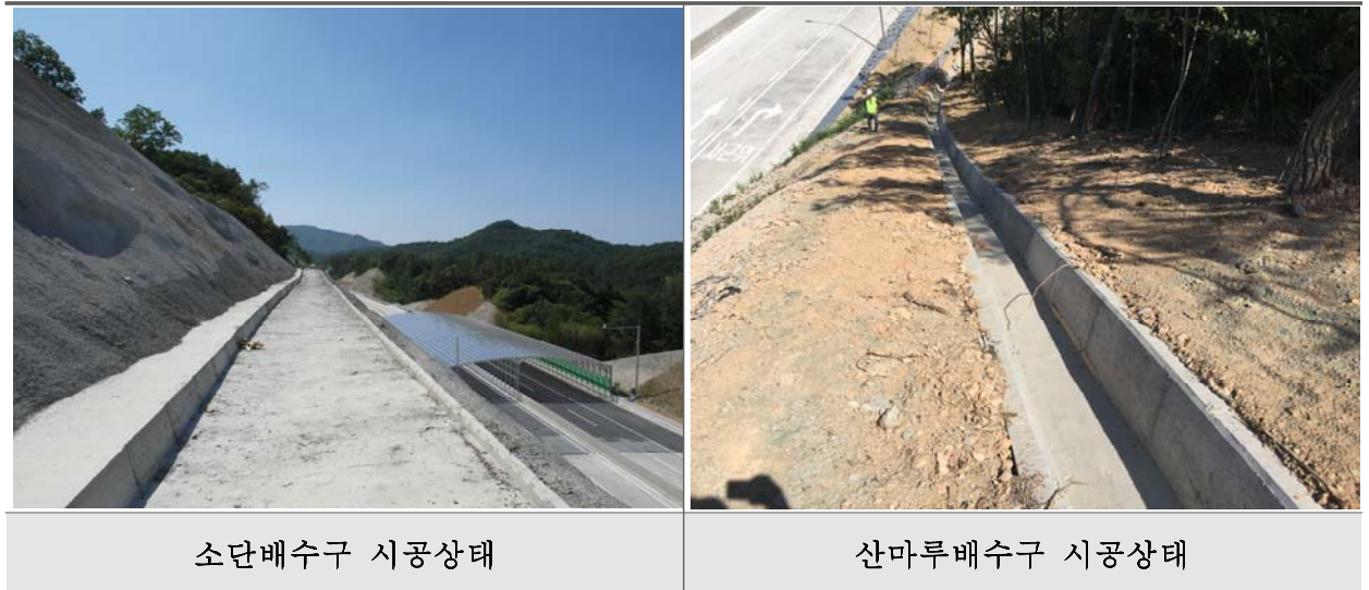
【표 12.2.8】 배수시설 손상물량
