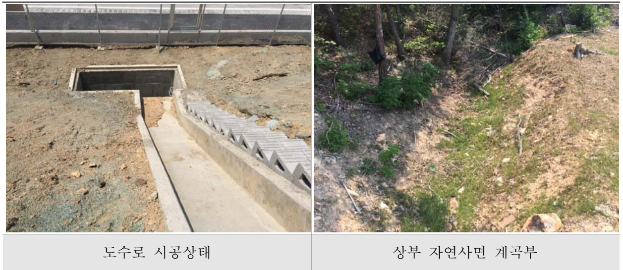
【표 2.2.4】 배수시설 손상물량
