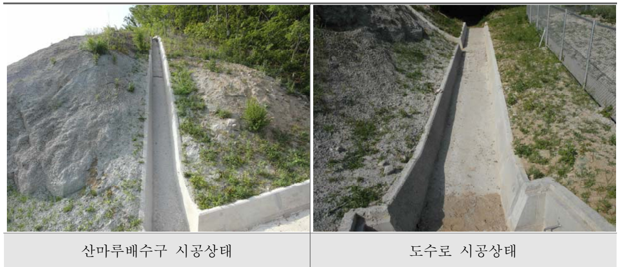
【표 10.2.8】 배수시설 손상물량
