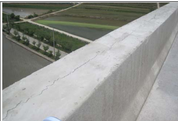
내 용 S1 방호벽 상단 균열
