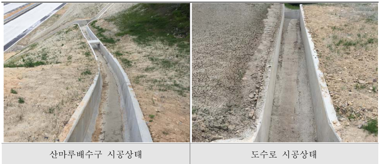
【표 7.2.8】 배수시설 손상물량
