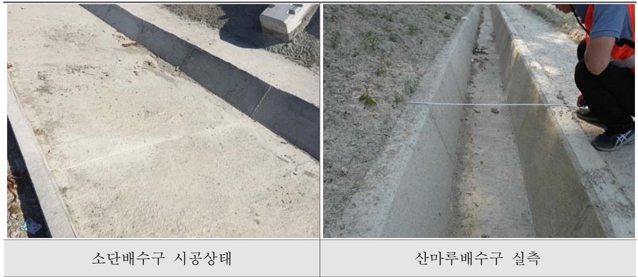
【표 11.2.3】 배수시설 손상물량
