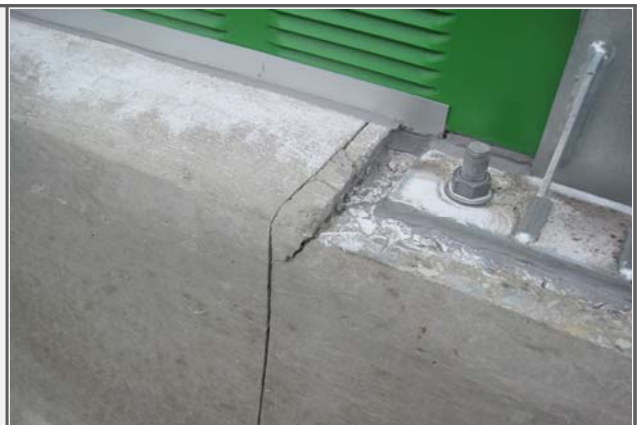
내 용 S2 방호벽 콘크리트 박리
