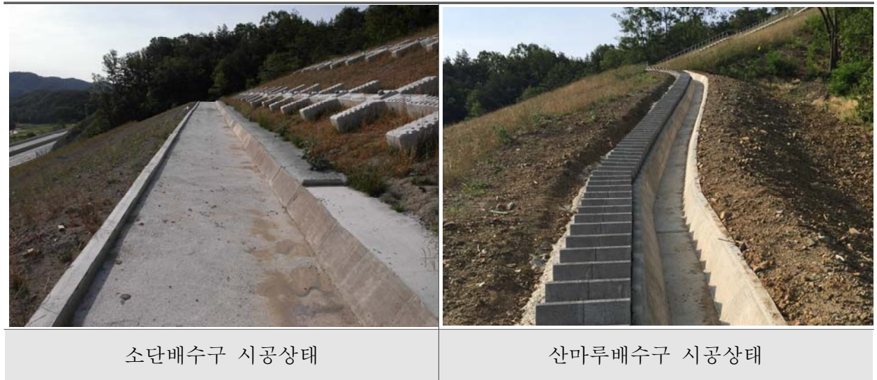
【표 10.2.4】 배수시설 손상물량
