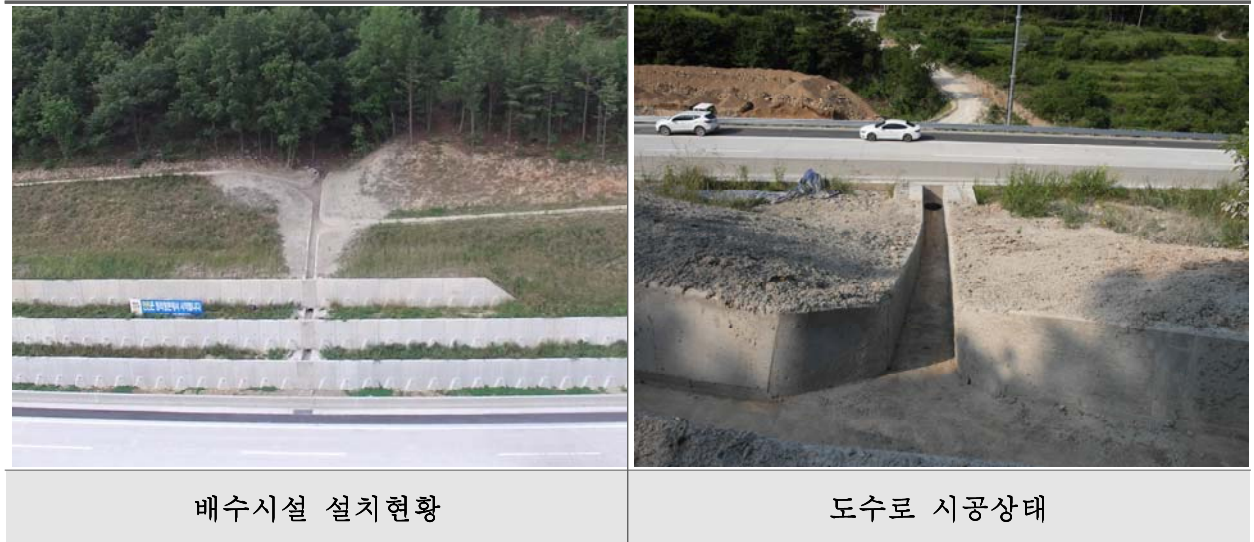
【표 4.2.12】 배수시설 손상물량
