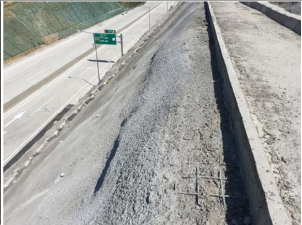
-shotcrete 와이어메쉬 노출
