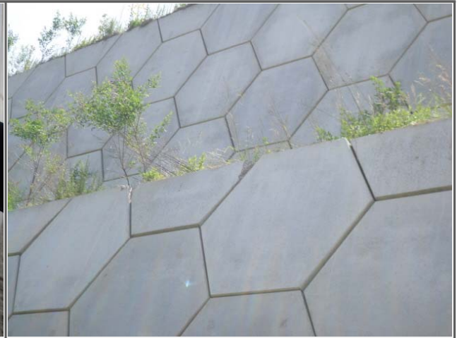
내 용 STA. 9+649 1단 벽체 패널 경미한 박리
