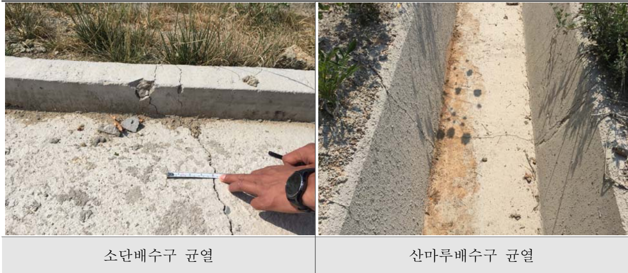
【표 3.2.3】 배수시설 손상물량
